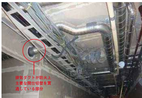
設計のポイントとなった天井での設備配管引回し。エアコンのダクトが強化石膏ボードを貫通している(建築基準法施行令114条にもとづく防火上主要な間仕切壁)。露出部の隙間は、モルタルなどで耐火処理する必要がある
