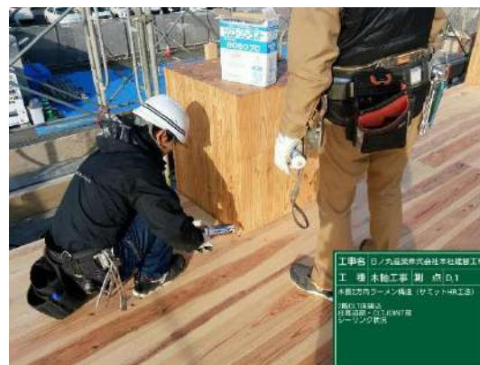
写真 2 取り合い部シーリング状況
