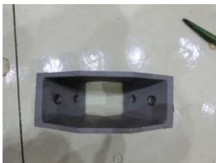
接合部の破壊状況（解体後）
